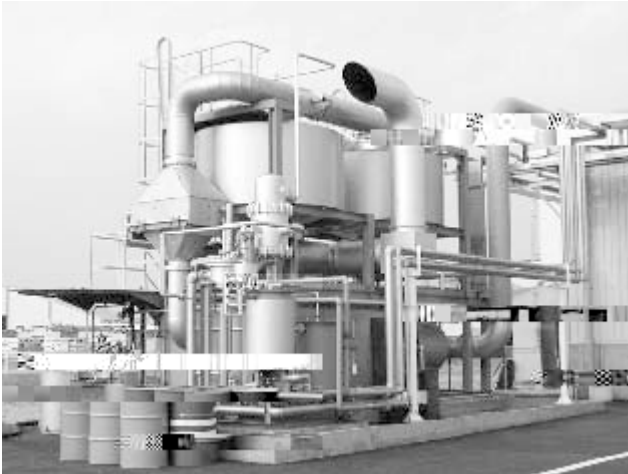
写真2 断熱フロン回収装置
